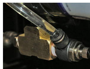
5 Controllo bypass flusso liquido di raffreddamento
